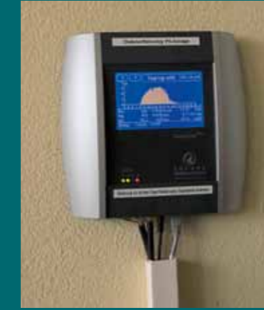
Solarlog 800e zur Erfassung der Daten der Photovoltaikanlage.
